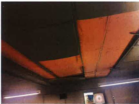
• 기계실 천정 유리섬유 흡음자재 탈락1
