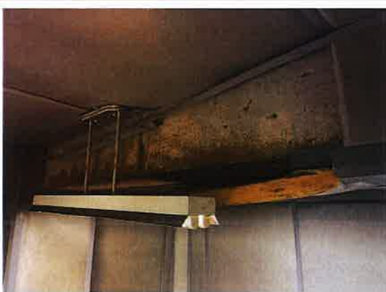
• 기계실 천정 유리섬유 흡음자재 탈락2
